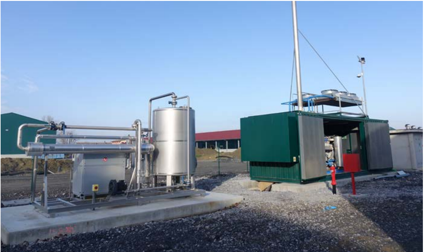
A sinistra, la pompa che indirizza al motore il biogas uscito dai due digestori. A destra, la struttura che contiene il motore
