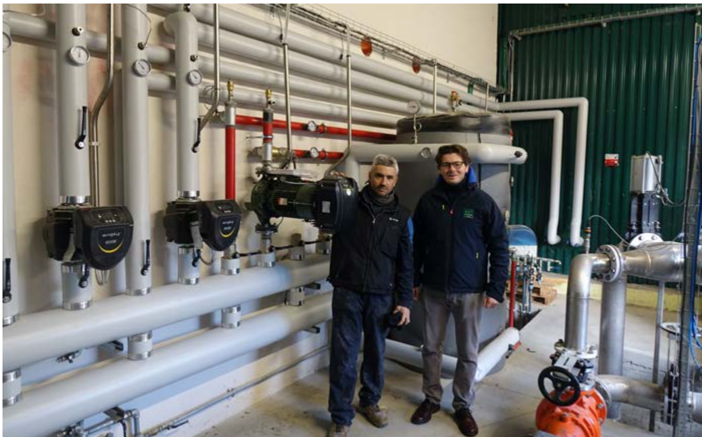
Pietro Ongari ed Edoardo Zaffignani all'interno dello spazio tecnico compreso fra i due digestori
