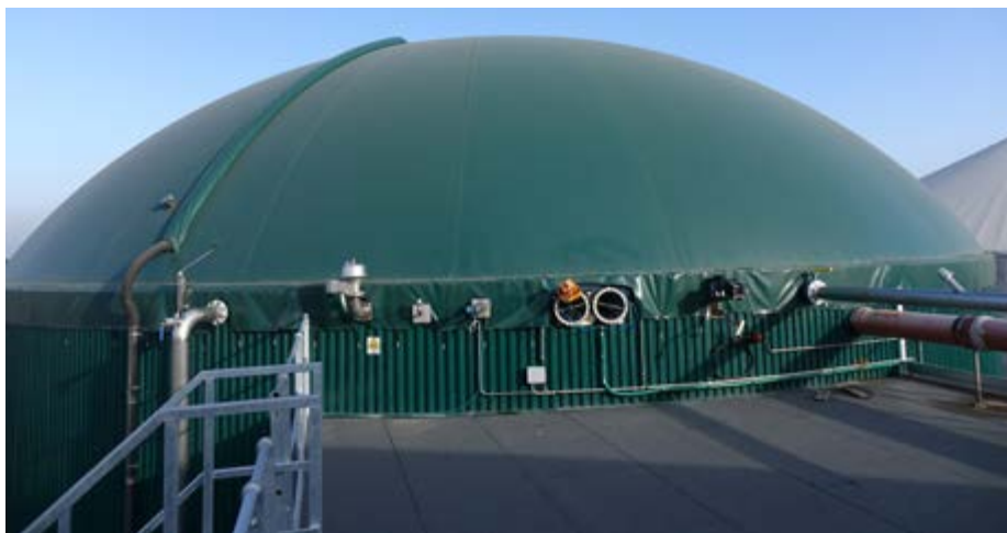
La parte apicale di uno dei due digestori. Le pareti verticali, che si notano anche nella foto sopra, sono di acciaio inox
