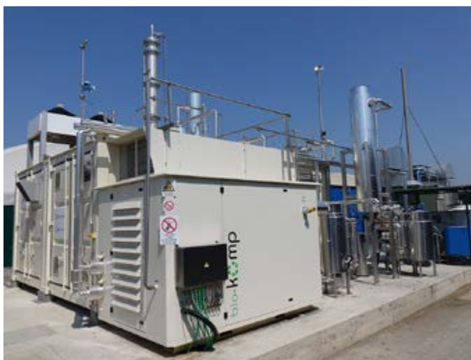
L'impianto di cogenerazione
