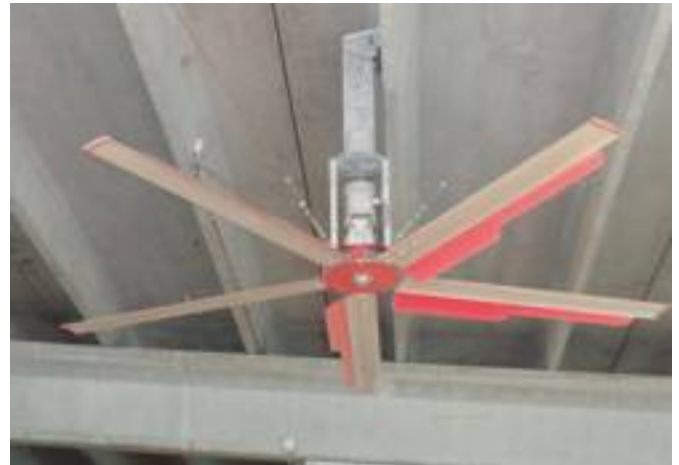
● Ventilatori verticali per l'arieggiamento estivo: poco dispendiosi e molto efficienti.
