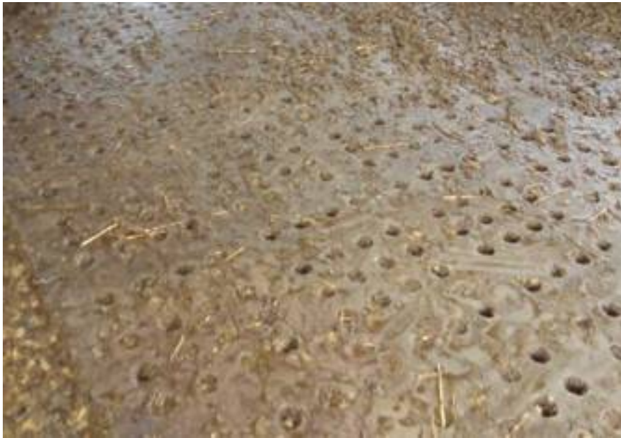
● Il vecchio pavimento forato resta più umido rispetto al nuovo grigliato posto in opera da Fattori.
