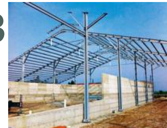
● Il cantiere nelle prime settimane di costruzione della stalla. In evidenza, fra l'altro, la buona pendenza (33%) della copertura.
