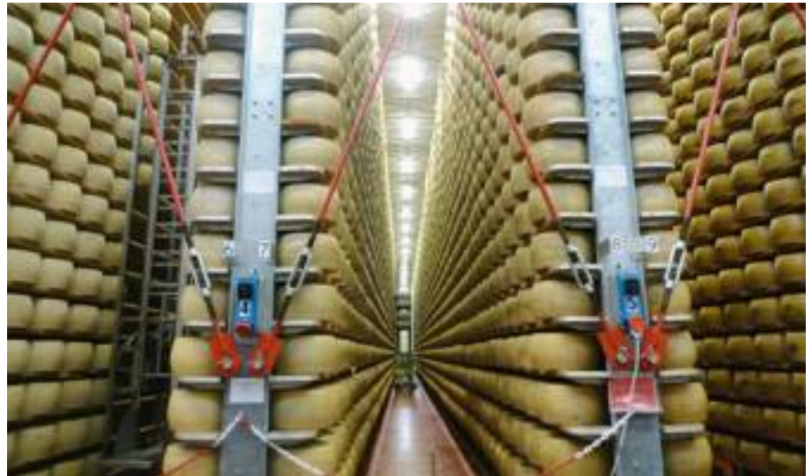
● Le nuove scalere antisismiche del caseificio al quale Valtolini conferisce il proprio latte: il Quattro Madonne di Modena, che produce Parmigiano Reggiano.
