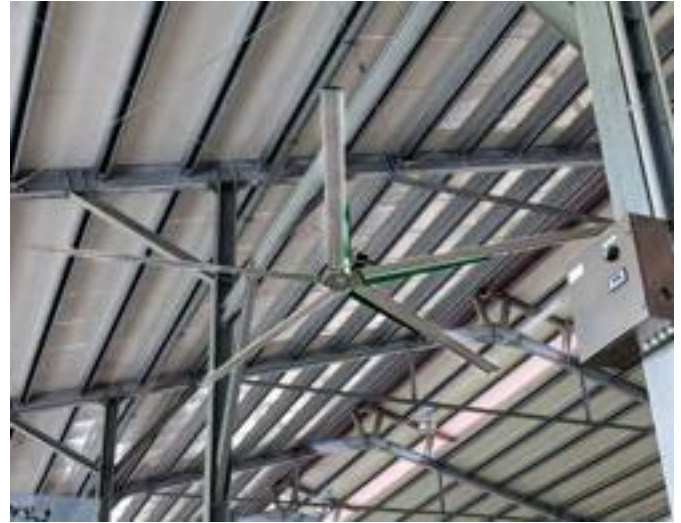
● Uno dei ventilatori: sono ben undici.
