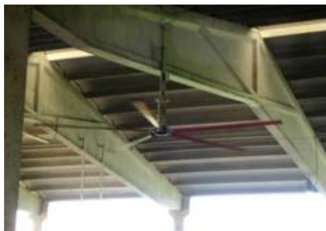
● Ventilatori a soffitto.
